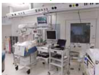
NICU(小児集中治療室) 新生児用呼吸循環監視装置等を配置
